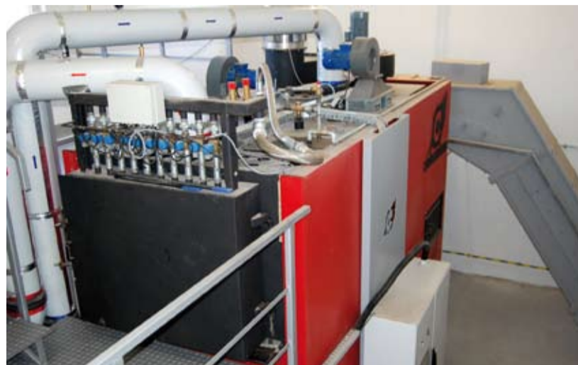
Automatyczna kotłownia z kotłem wodnym CE90DH-P w firmie Delta Gartenholz Polska.
