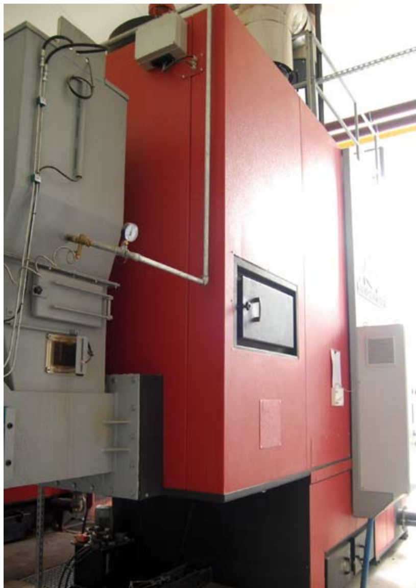
Kocioł o mocy zainstalowanej 1200 kW spala biomasę o wilgotności do 55 proc., która wcale nie musi być rozdrobniona.
